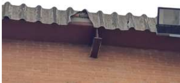
Detalle de piezas del alero rotas de la cubierta de fibrocemento.
