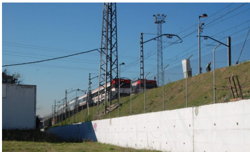
Talud y muro de separación entre el ámbito y el ferrocarril. En este tramo no circulan los trenes sino que sirve de zona de estacionamiento.
